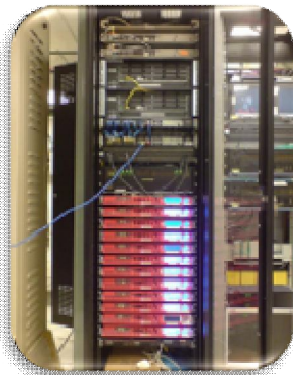
RTM IBC - HQ
